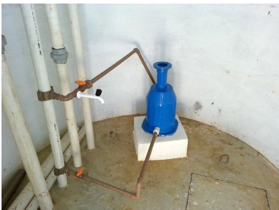
Figura 11: Equipamento de cloração de SAA
