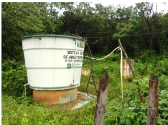
Figura 13: Chafariz na aldeia Mambira
