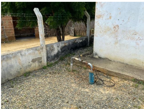
Figura 9: Poço tubular de SAA
