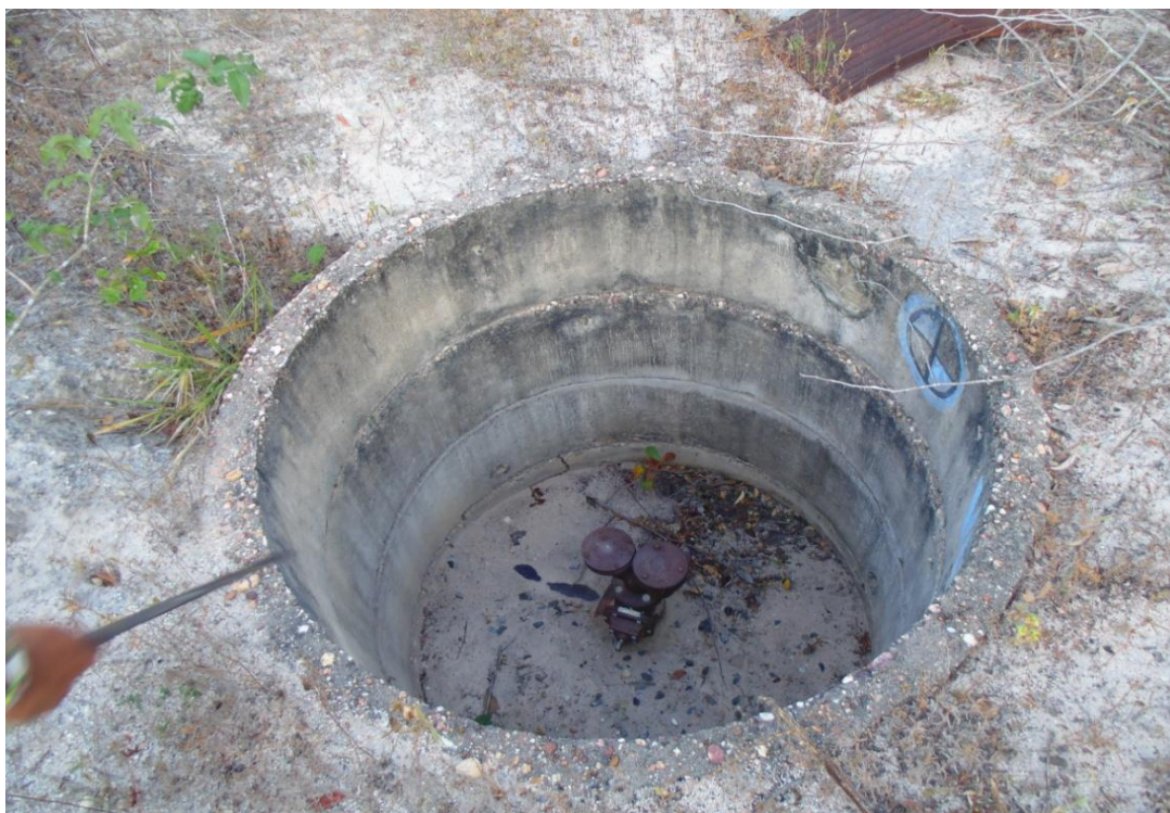
Figura 5: Estrutura de concreto instalada pelo DNOCS com suporte para bomba de água.
